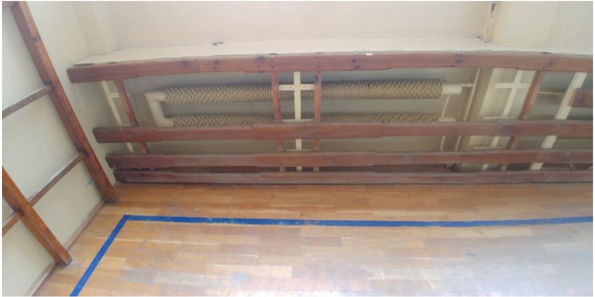
fragment ściany z grzejnikami w sali dużej
